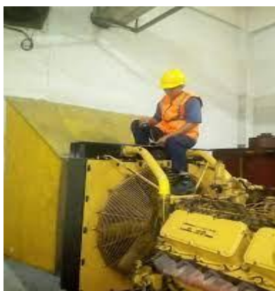
Gambar 11. Sistem Pendingin Mesin Genset
